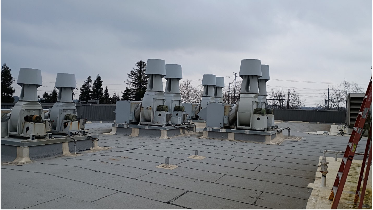
Pic – 1 Exhaust Fan Area
